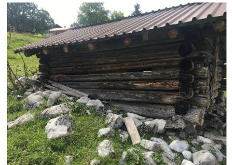
Les ondulations de la tôle profilée sont trop grossières par rapport à la taille du bâtiment.
